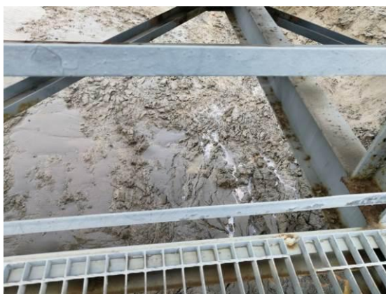
图3-10 码头管道泄漏点
