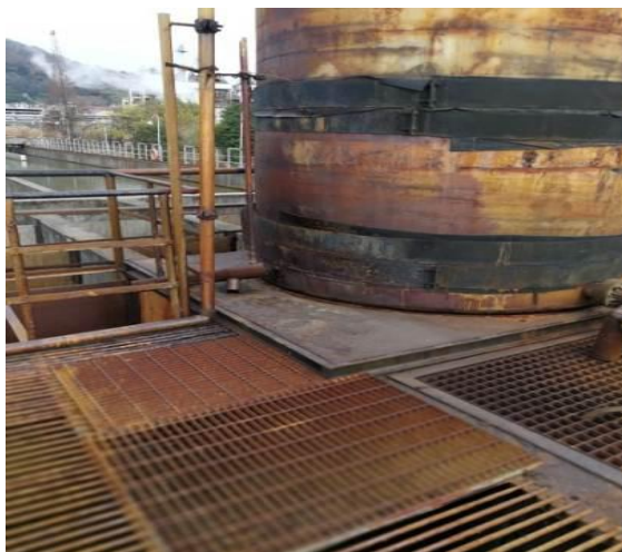
图3-7 厂区部分设施腐蚀情况
