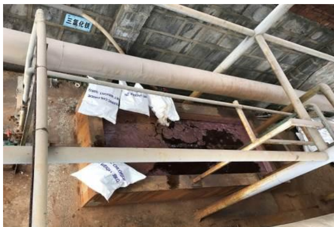
图3-4 污水处理站，三氯化铁添加池
